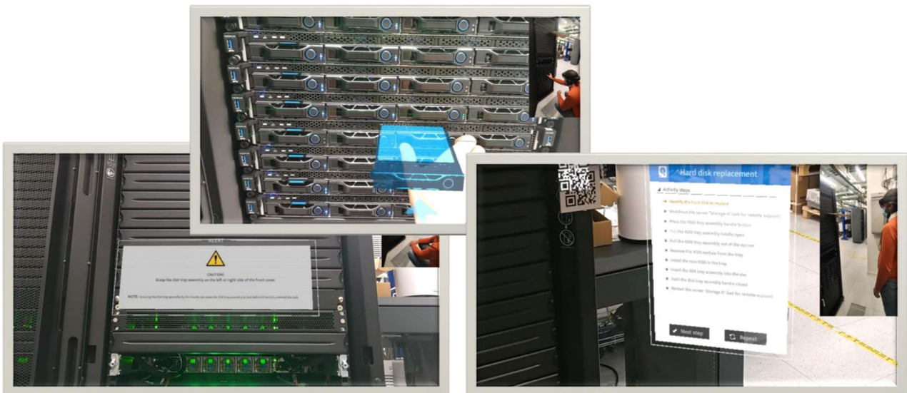
Fig. 2.16 - Sicurezza indoor: interventi in server farm
